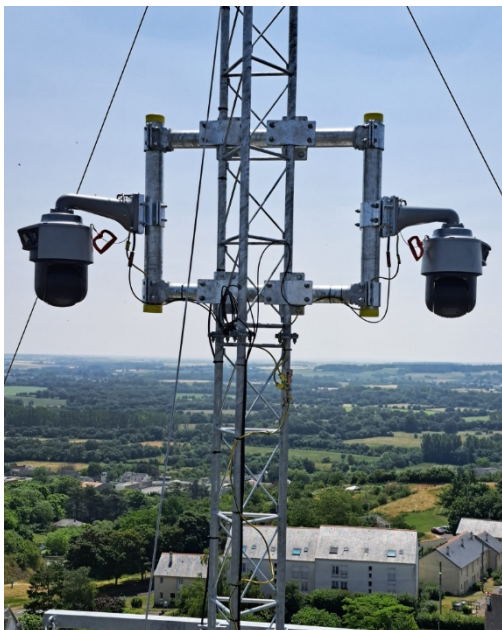
Caméras FireTracking installées sur un pylône télécom
