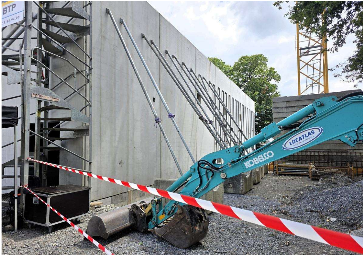
Le bâtiment qui doit abriter le data center est en construction au nord-est de Pau, près du centre technique municipal. Luce Gardères
